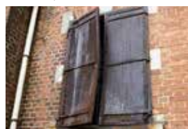
爆心地から2,7キロメートル離れた鉄の扉が変形している
