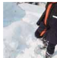
屋根の積雪状況
